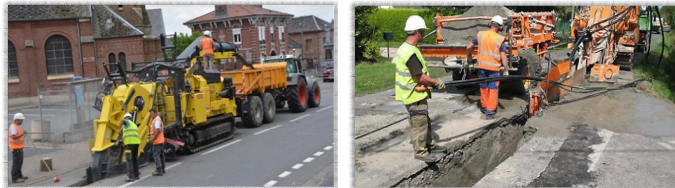
Figure 281 : Illustration d'un passage de câbles électriques sous voirie (Sources : La Voix du Nord, Ouest France)
