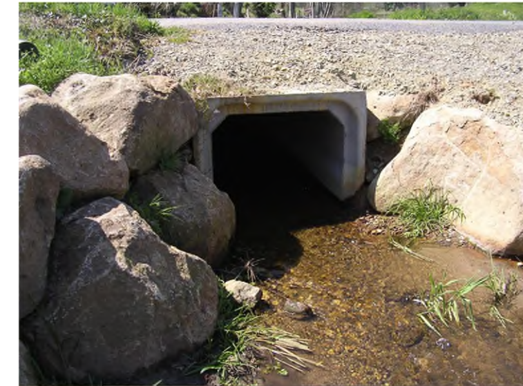
Figure 295 : Exemple de pont cadre de type « Dalot béton » (Source : Observatoire des poissons de Seine-Normandie)
