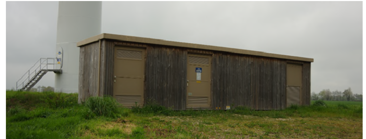
Figure 280 : Aspect extérieur du poste de livraison du parc éolien de Maxent, actuellement en service (Source : Résonance)
